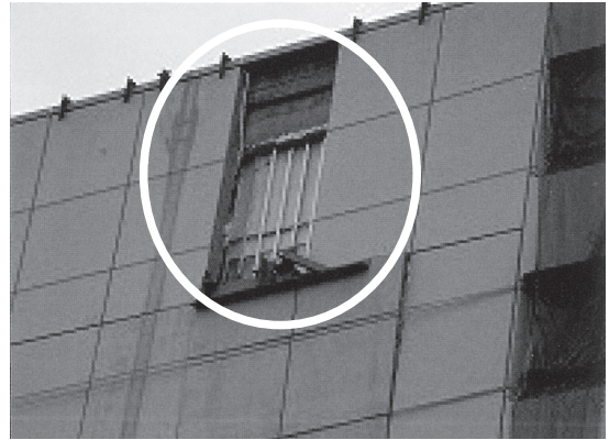
写真 2.1-2 脱落被害事例 2), p.524
