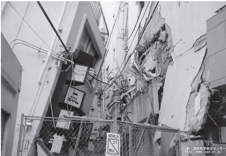
写真3 雑居ビルの被害の様子（阪神・淡路大震災）（災害写真データベースより）
