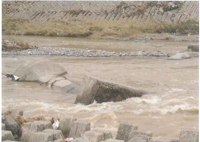
2004年福井豪雨による越美北線の第1 鉄橋おける橋脚の倒壊
