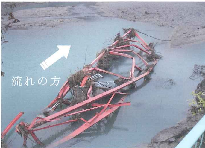
2005年宮崎水害による耳川町村道の小 原橋桁の流出
