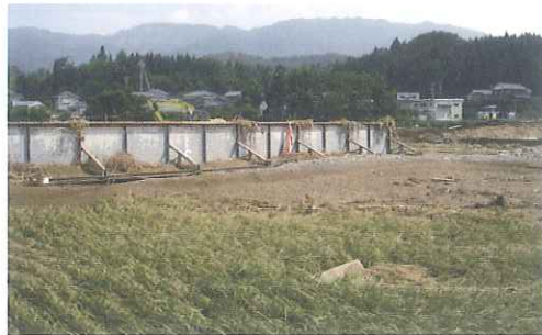
(c) 堤内地に侵入した橋桁(堤内地寄りから撮影) (出典: 榎田)
