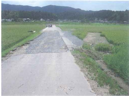
(b) 堤内地の農道舗装の剥離
